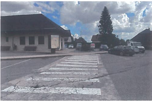
Traversée piétonne dégradée
