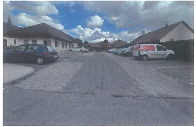
Enrobé vieillissant, imperméabilité du sol
